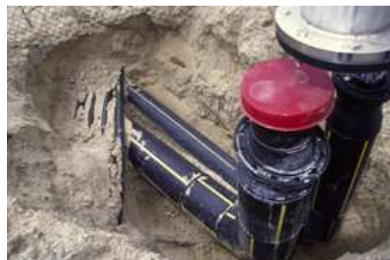
Biogas Well-Amarsul Landfill Site
